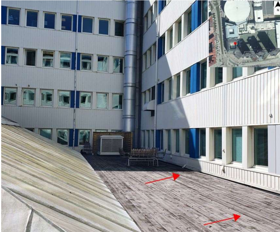
Figur 30. Takavvattning södra byggnadskomplexet.
